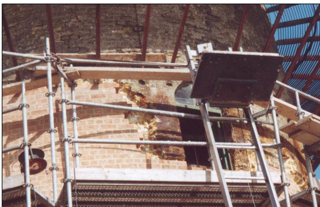
Het herstellen van het metselwerk aan de molenromp onder de gaanderij in oktober 2002.
